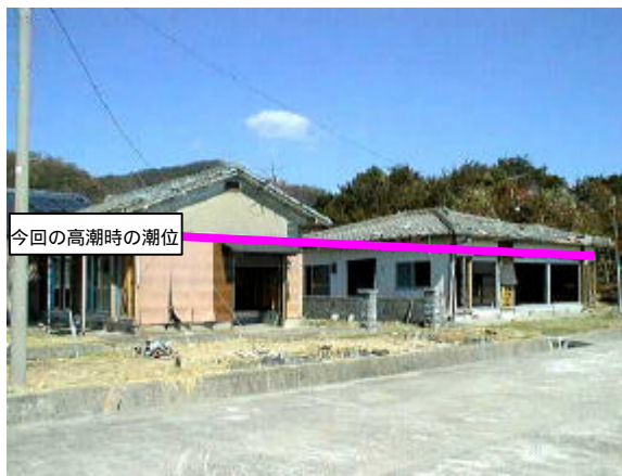
写真 2.3.5 全壊した住家の様子 高潮害を受けてほぼ全壊した海岸線沿いの住家 龍ヶ岳町小屋川内地区
