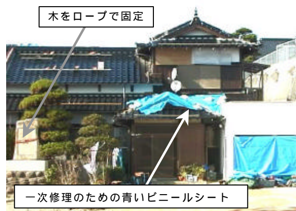
写真4.2.2 屋根瓦の飛散した家屋(2) (建築年代の古い家屋・倒木回避のためロープで固定/宇部市床波漁港付近)
