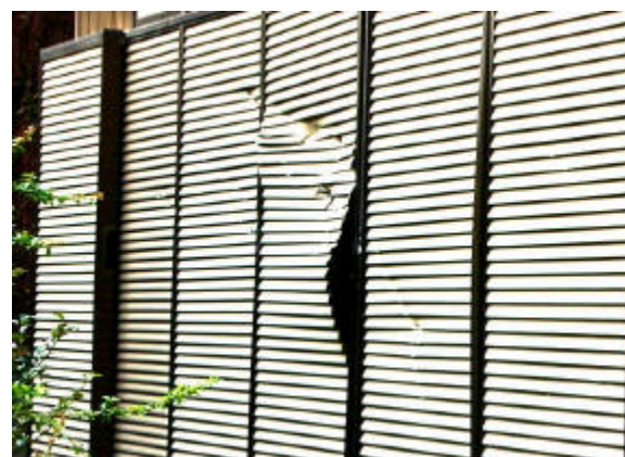
写真4.4.2 竜巻による飛来物のため湾曲した家屋の雨戸(小野田市雀田付近)
