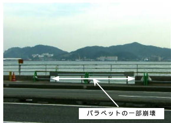
写真4.3.2 海側歩道のパラベットの崩壊箇所の一部(下関市国道9号)
