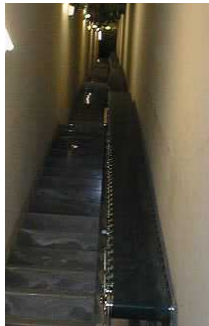
図7 緊急物資輸送コンベア
